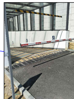
车库入口排水沟
