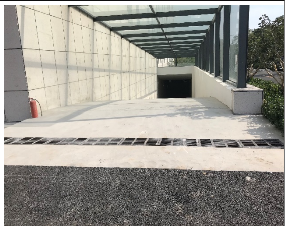
地库出入口截水沟
