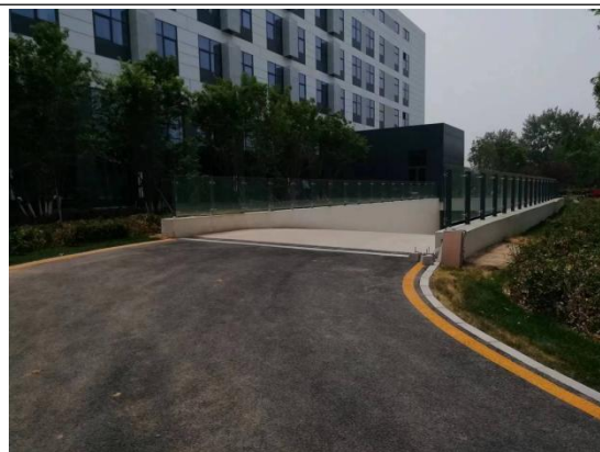
地库出入口截水沟
